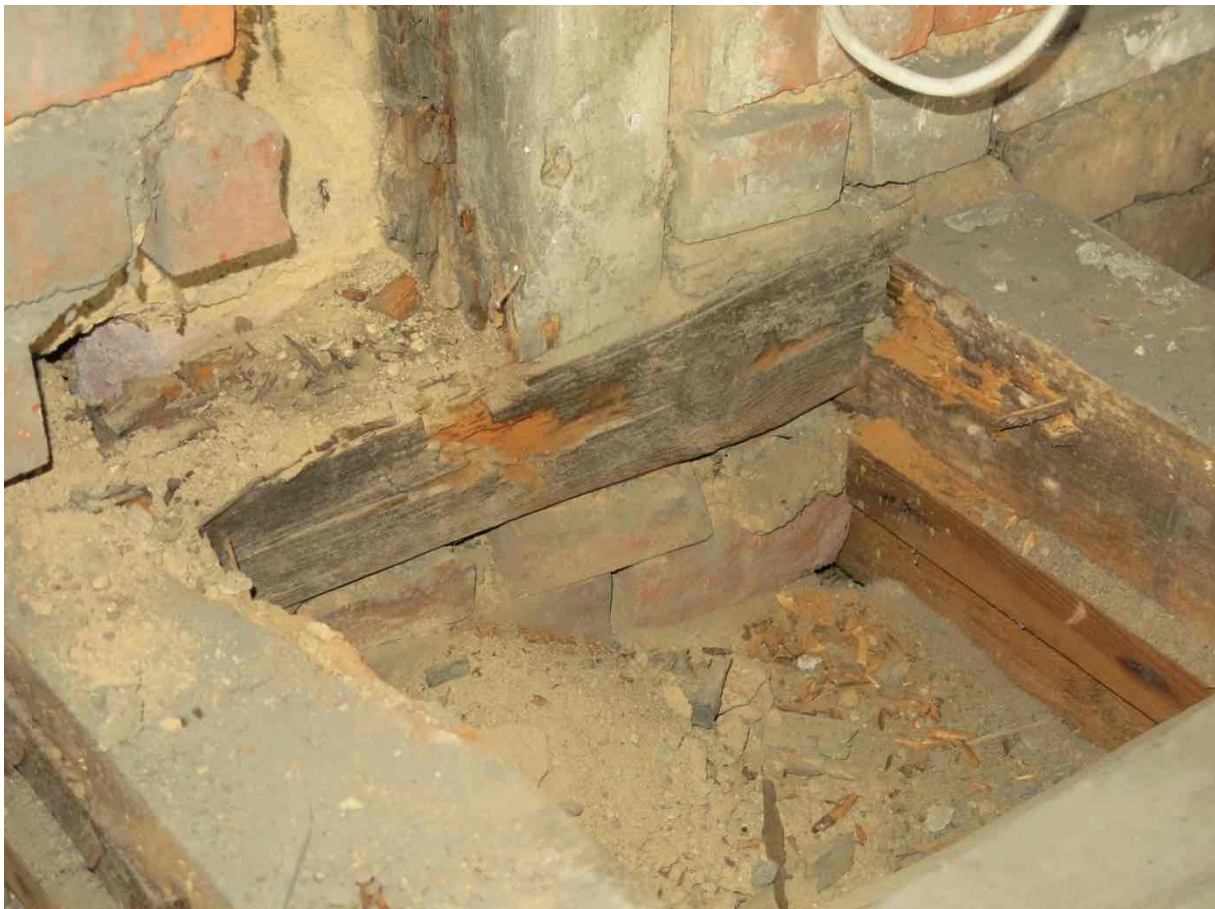
Dachgeschoss Balkenköpfe und Außenwand im Bereich des Frontgiebels, Achsen 19 – 20/ A
