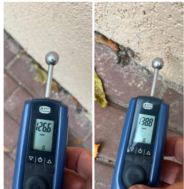
Bild 14, messtechnisch feucht-nass, dazwischen auch messtechnisch trockene Bereiche (vorerst wurden keine Bohrungen für Tiefenmessung durchgeführt, da die Messergebnisse offensichtlich sind)
