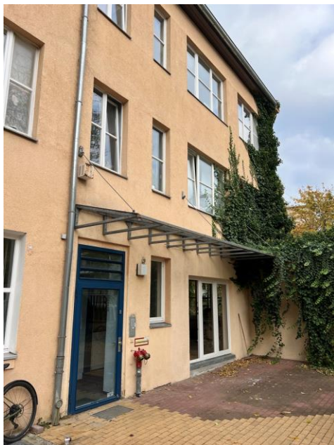
Bild 13, auch die Außenwände rings um das zugängliche Gebäude sind messtechnisch feucht-nass
