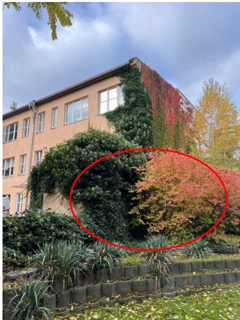
Bild 15, auch im weiteren Verlauf um das Gebäude sind die Messwerte ähnlich, auch sind einige Bereiche intensiv bewachsen, sodass Beschädigungen an der Fassade kaum erkennbar sind
