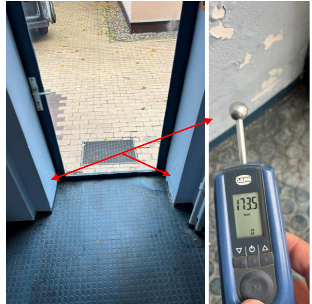
Bild 12, auch im Treppenhaus sind die Sockelbereiche messtechnisch feucht-nass
