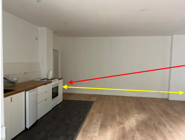
Bild 3, auch in Richtung Kammer hinter der Küchenzeile ist, wenn auch in leicht abgeschwächter Form, messtechnisch Feuchtigkeit im Sockel Bereich vorhanden
