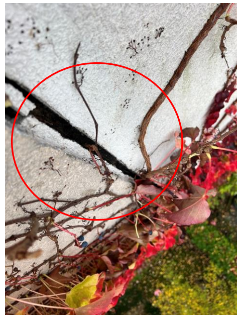
Bild 18, die Gebäudefuge ist altersschwach und kaum einsehbar (Einwachsungen und Überwucherung sind vorhanden)
