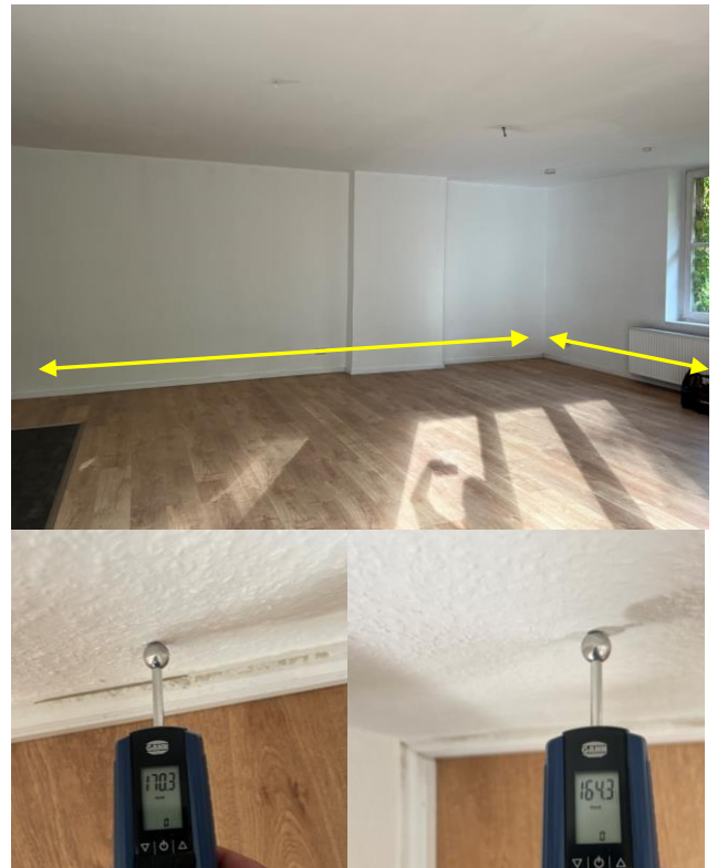
Bild 2, EG: gemeldeter Schadensbereich ist markiert, die Wände sind sockelseitig nahezu durchgehend messtechnisch feucht-nass, erst ab einer Höhe von ca. 40-50 cm verliert sich die Nässe
