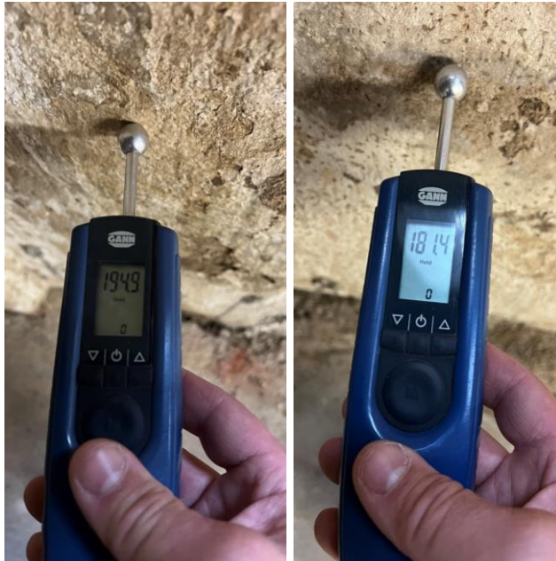
Bild 11, da die Wände jedoch nahezu durchgehend messtechnisch nass sind, scheint der augenscheinliche Abdichtungsversuch nicht geücker (messtechnisch nass) die Feuchtigkeit zieht sich bis unter die Decke
